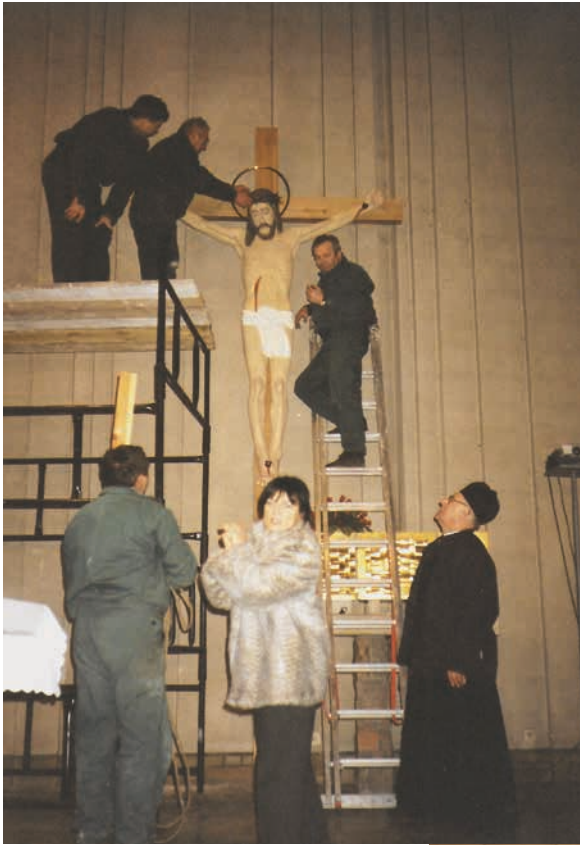
Montaż ostatecznej wersji rzeźby „Ukrzyżowany” na ścianie głównej prezbiterium kościoła w Orońsku (rok 2000)
