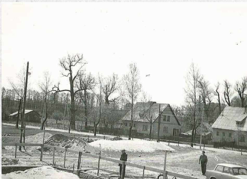
Wykopy pod fundamenty nowego kościoła w docelowym miejscu, w prawym dolnym rogu samochód ks. Zasonia marki Trabant (rok 1974)
